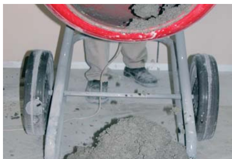
Mortar cu aspect de "nisip ud".
